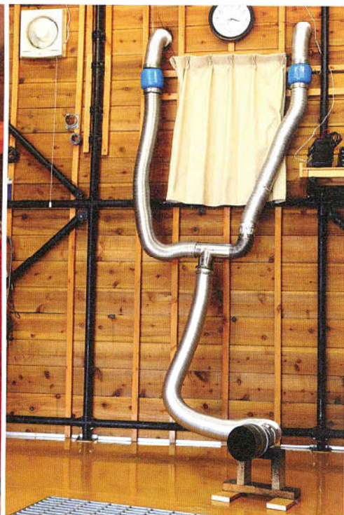
ホームセンターで見つけた換気扇を使って排気ダクトを考案。安くできたが、パイプは経年変化するので時期をみて交換が必要だそうだ。
